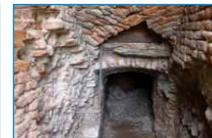
Az építési kövek szétroncsolódása
