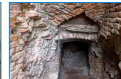
Az építési kövek szétroncsolódása
