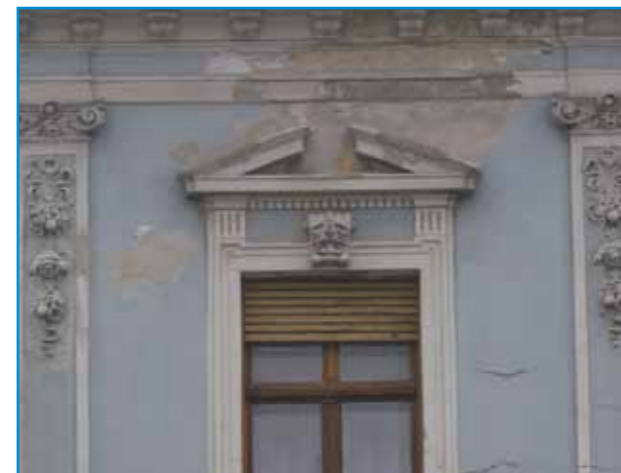
Keszthely, Fő tér - nyitott timpanonos ablakkeretezés felújítás előtt
