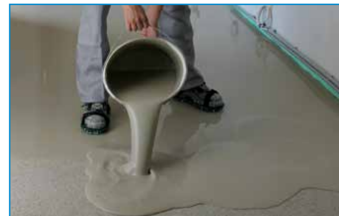
A homogénre kevert aljzatkiegyenlítőt vödörből végzett terítéssel hordjuk fel a megfelelően előkészített aljzatra.
